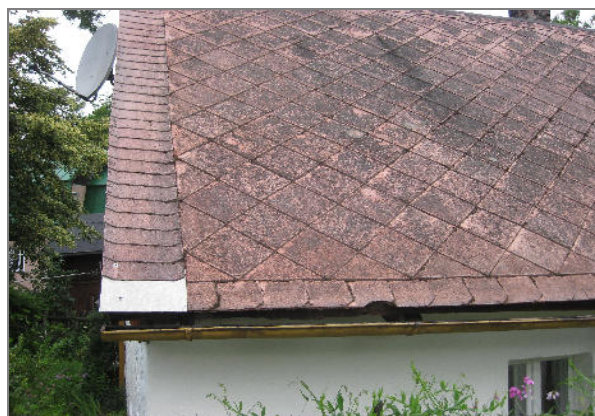
Fot. 2 Płyty azbestowo-cementowe płaskie
