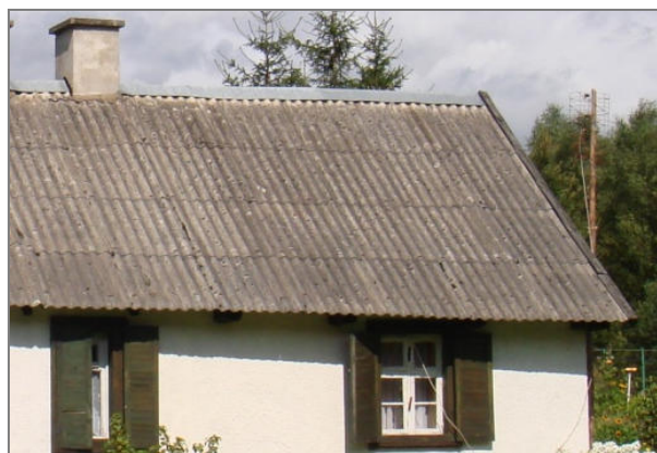
Fot.1 Płyty azbestowo-cementowe faliste
