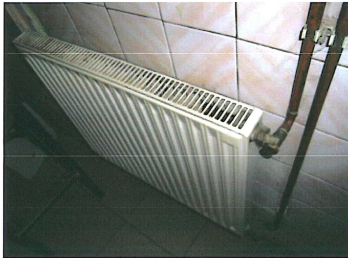
Rysunek 14. Grzejnik płytowy w pomieszczeniu w szkole w Słuczu (źródło własne)
