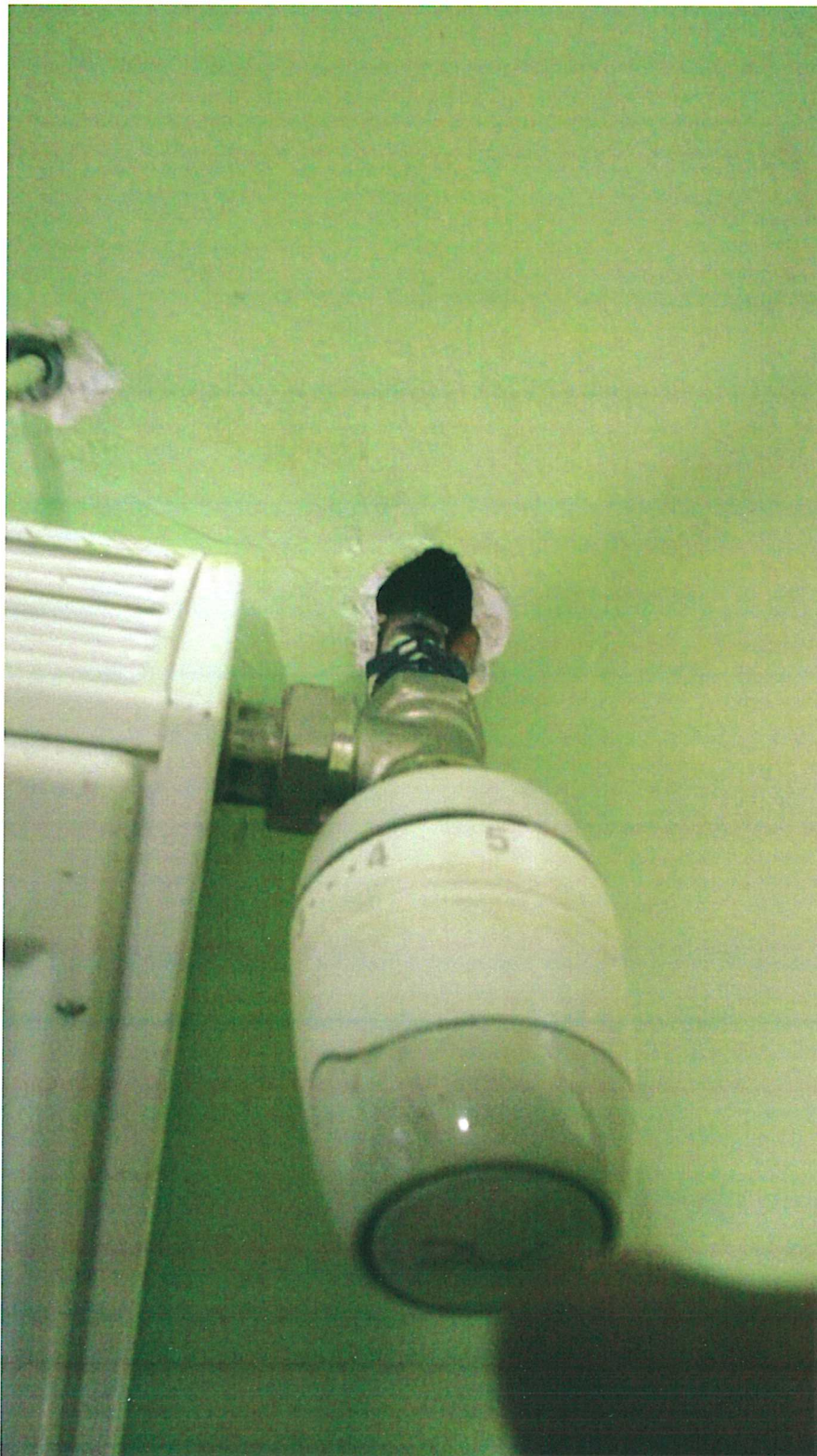
Rysunek 8. Głowica termostatyczna na grzejniku płytowym w szkole w Słuczu (źródło własne)
