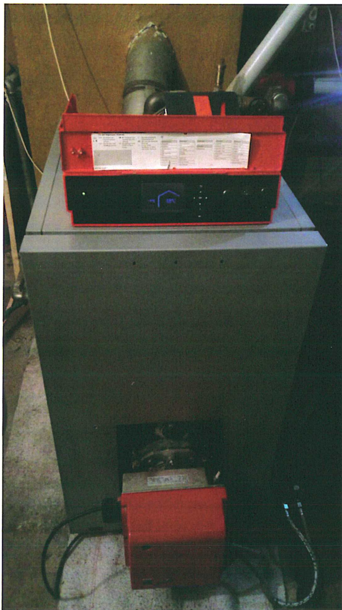
Rysunek 10. Kocioł zamontowany w kotłowni w szkole w Słuczu (źródło własne)
