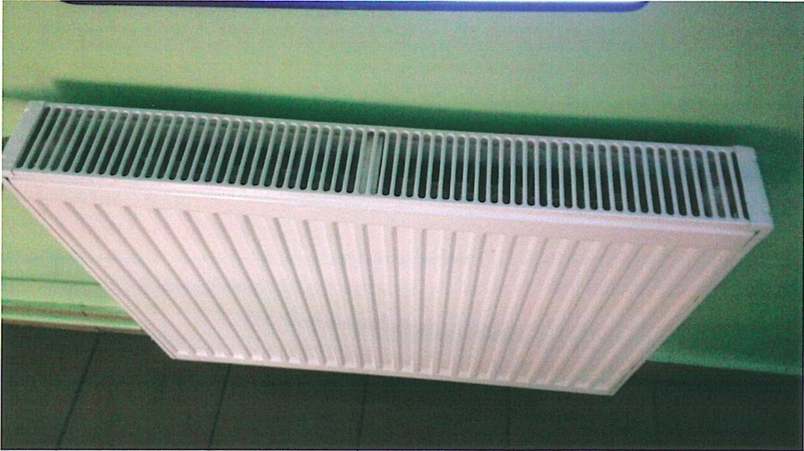
Rysunek 6. Grzejnik płytowy zamontowany w szkole po modernizacji c.o. (źródło własne)
